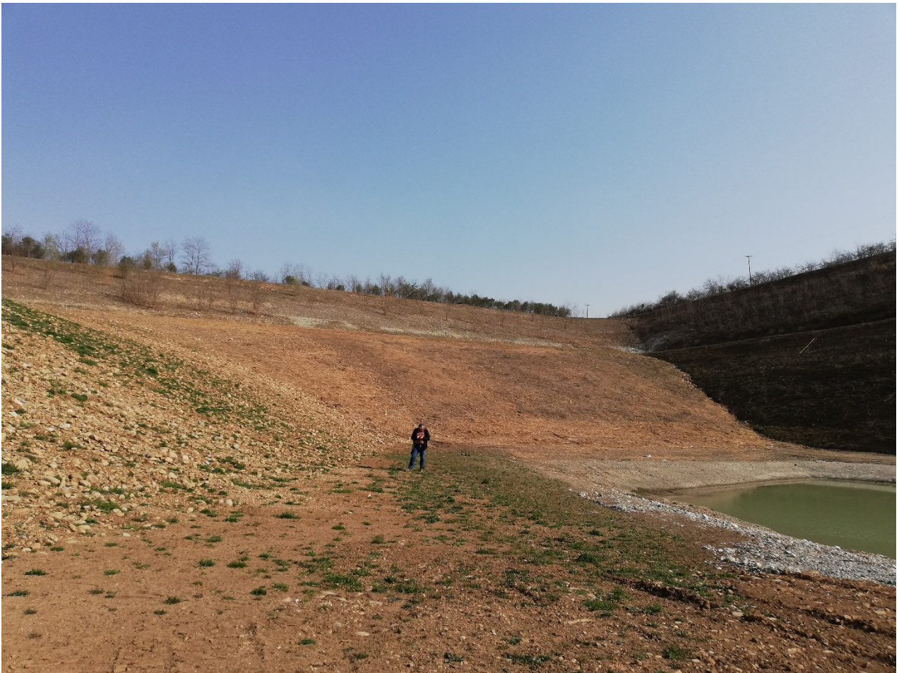
Foto 5: lato est, area sovrastante il lago. Interventi di ripulitura della scarpata nella parte sommitale e preparazione della parte basale per gli interventi di semina, già completati alla data di aprile 2022
